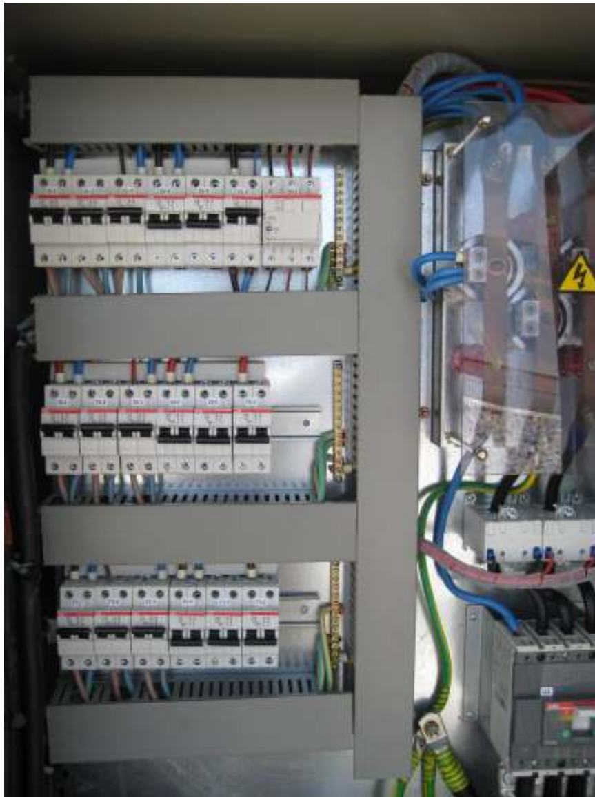
Εσωτερικό 3-φασικού πίνακα
