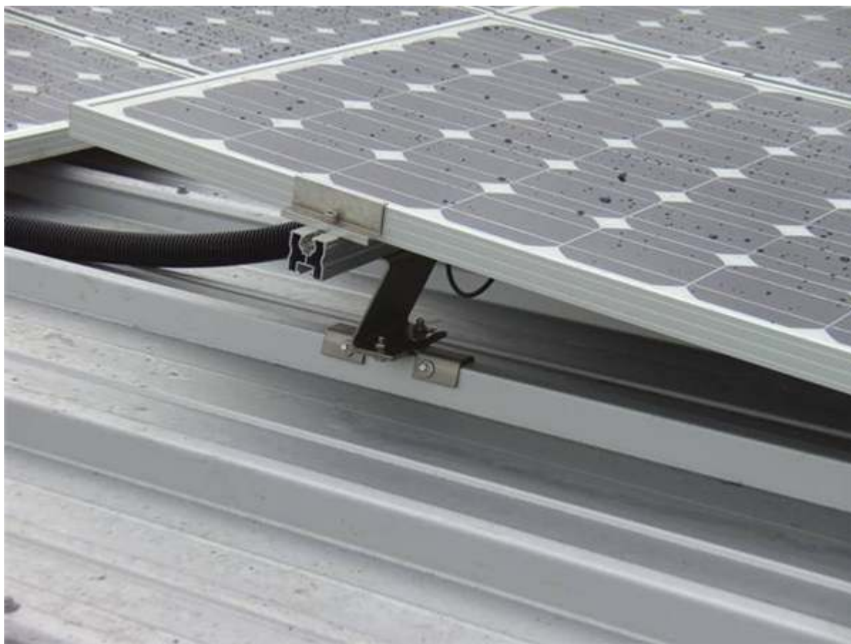
Σχήμα 28: Σταθερές βάσεις σε οροφή κτιρίου
